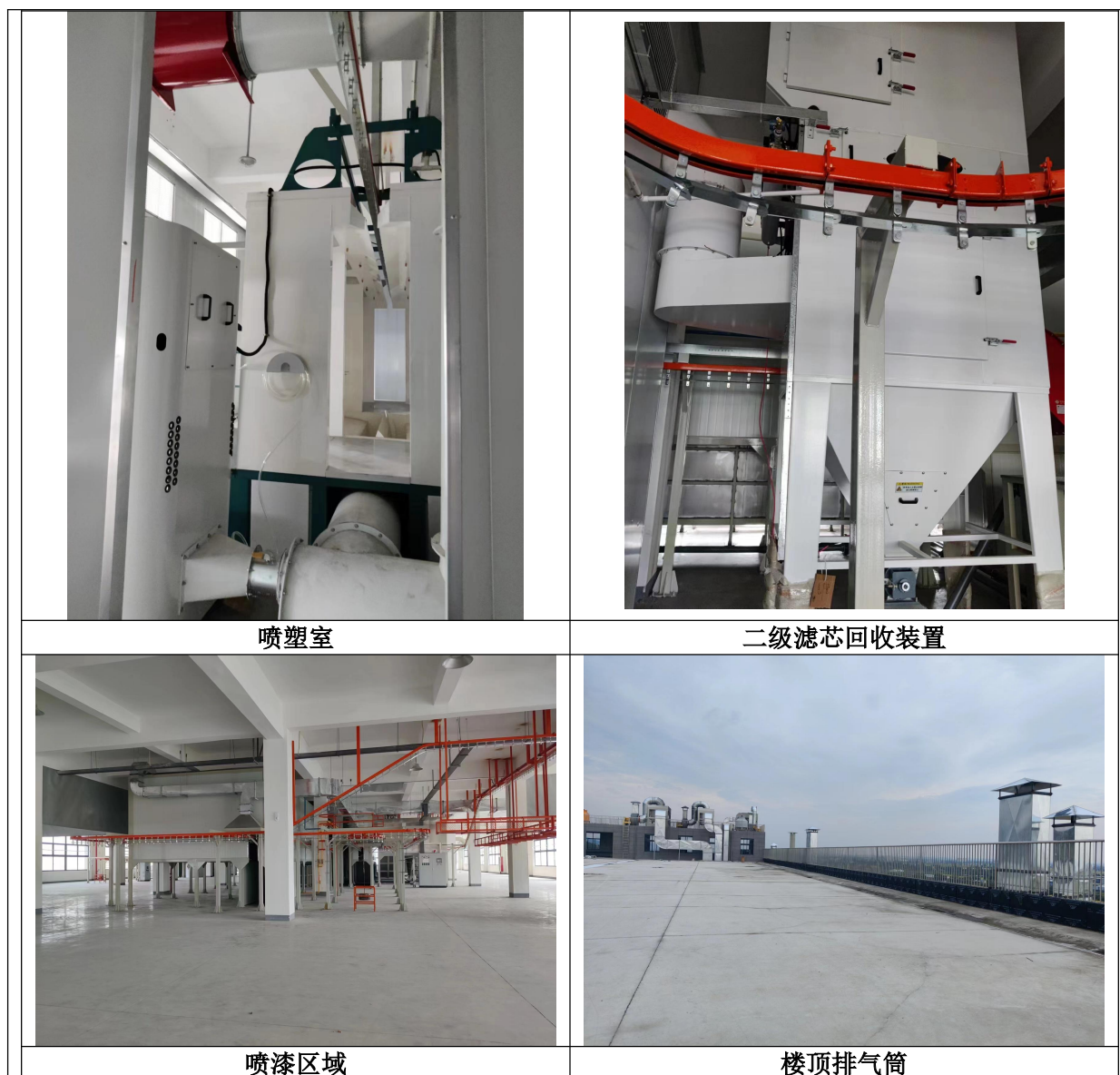
图 3-3 废气处理设施相关照片
