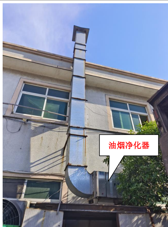
图 3-2 废气治理设施照片
