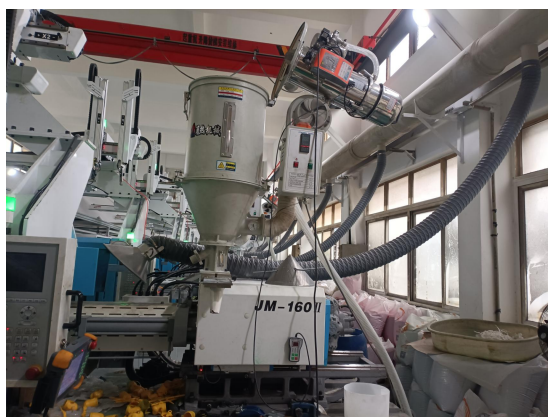
注塑废气收集措施
