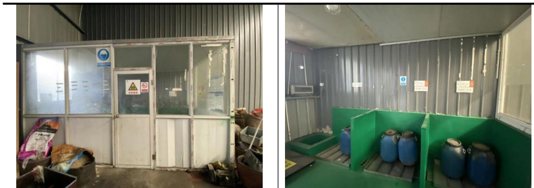
危险废物仓库
