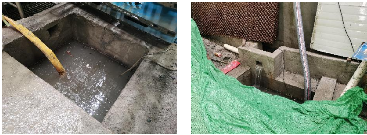
2) 废水治理设施图片
