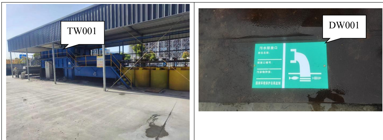
图 3-6 厂区污水处理站废水治理设施照片
