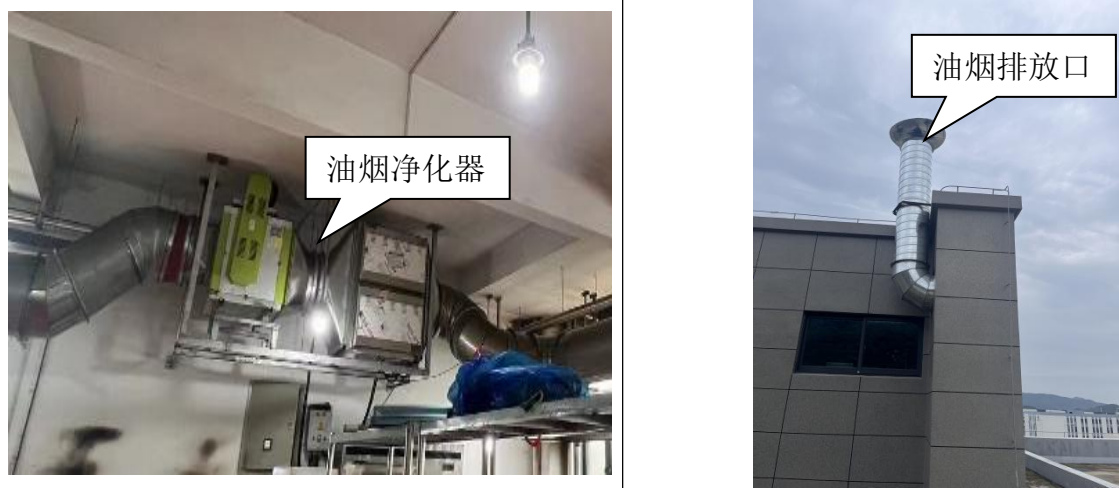
图 3-6 食堂油烟治理设施照片
