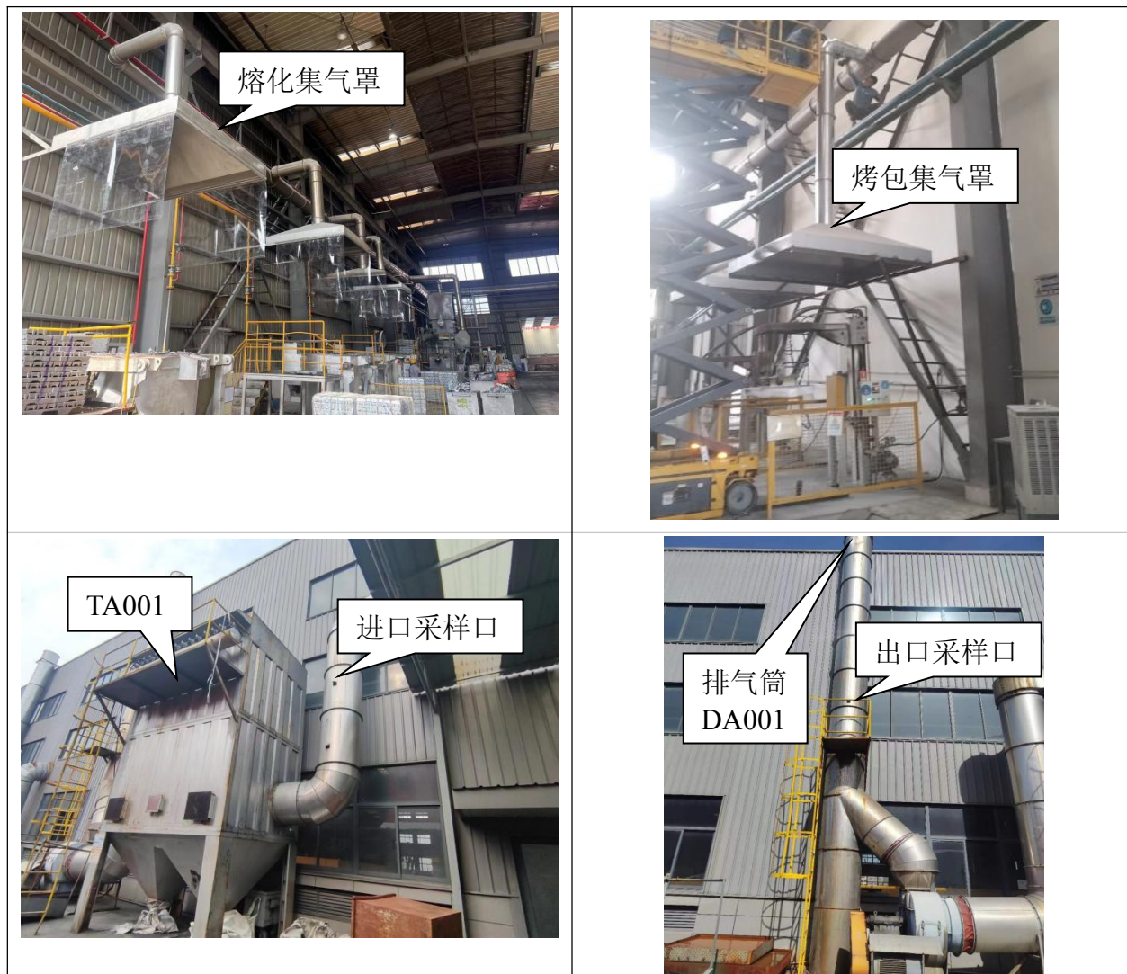
图 3-2 熔化烟尘、天然气燃烧废气治理设施照片
