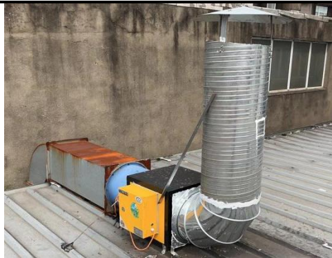
食堂油烟排气筒
