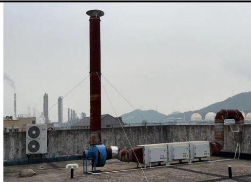
注塑废气排气筒
