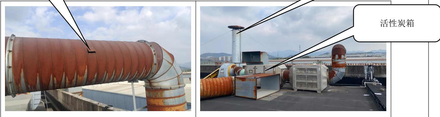
图 3-2 废气治理设施照片
