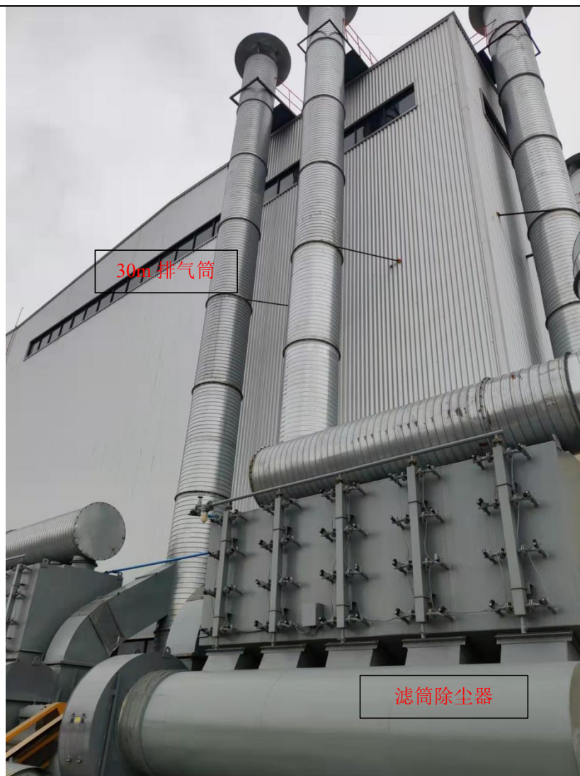
图 3-2 喷砂废气环保设施
