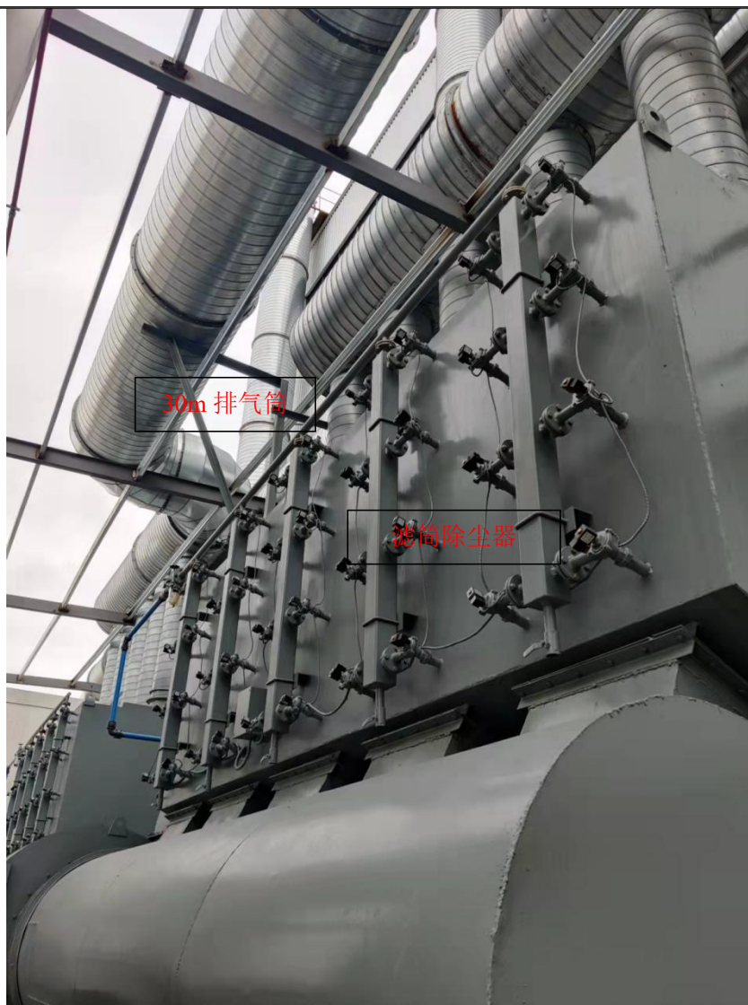
图 3-4 喷砂粉尘处理设施
