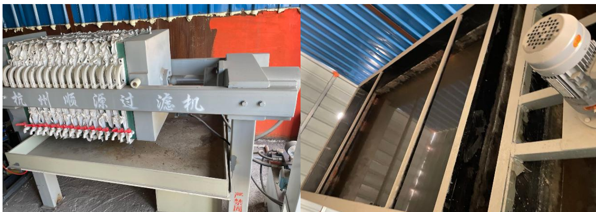
图 4-1 厂区污水处理站
