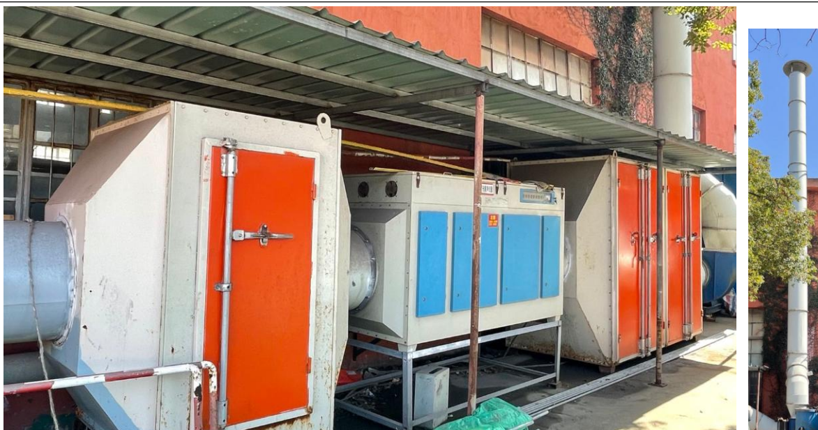
图4-6 废气治理设施
