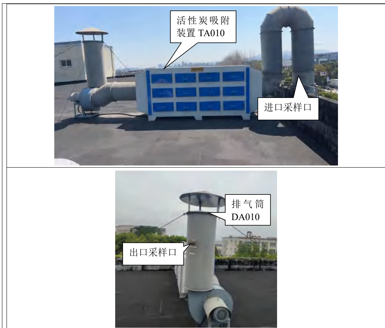
图 3-6 丝印、烘干废气治理设施照片
