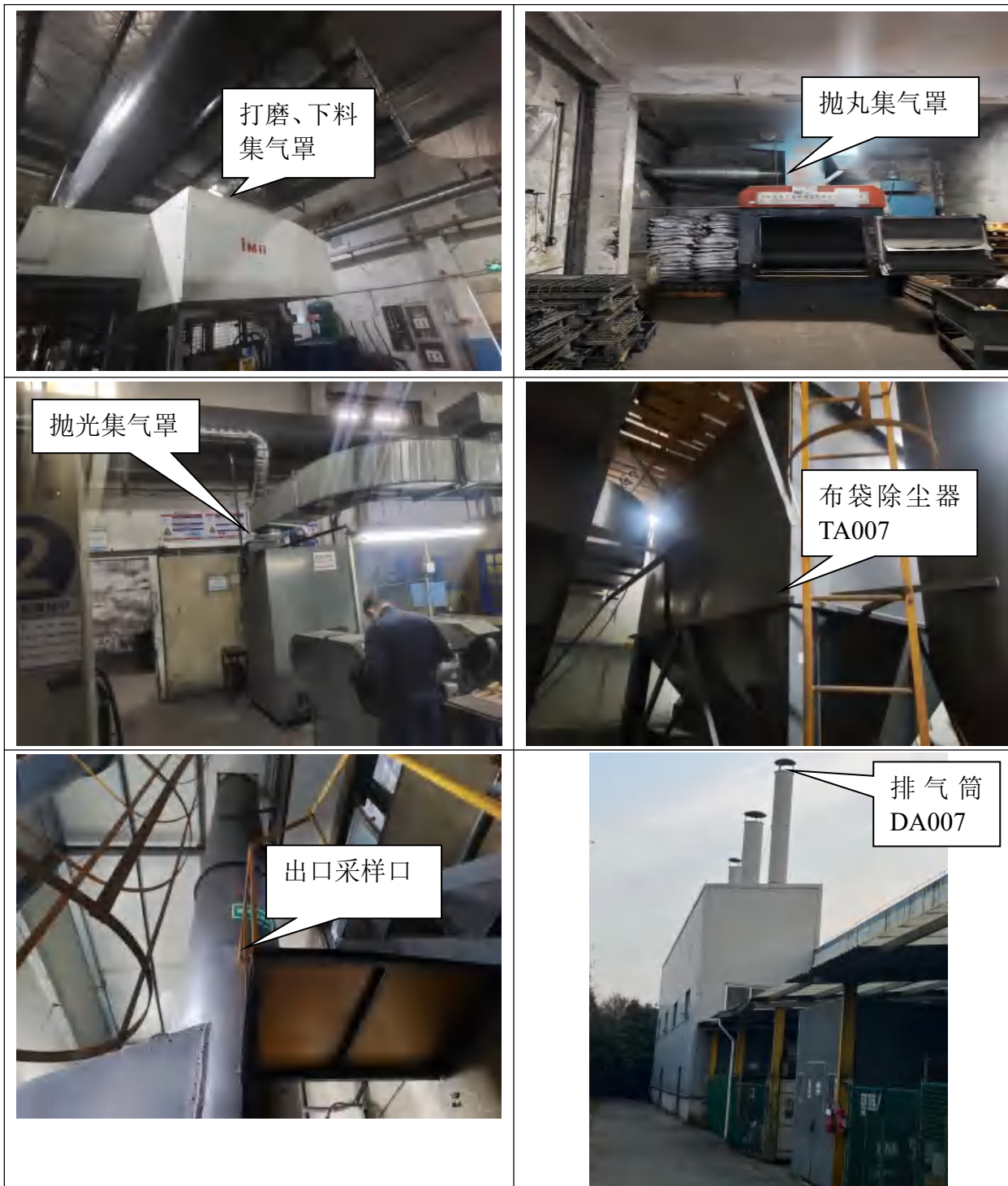
图 3-2 打磨下料、抛光、抛丸粉尘治理设施照片
