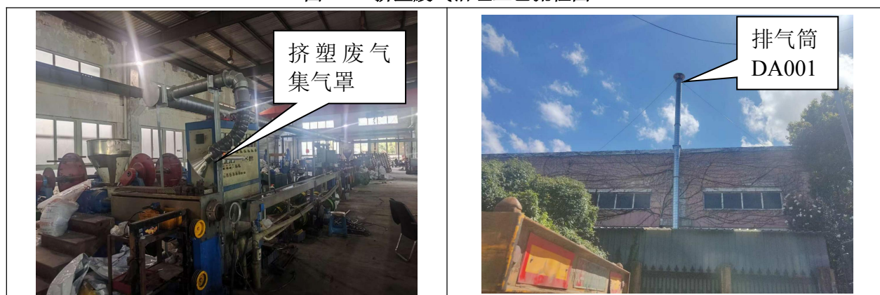
图 3-2 挤塑废气治理设施照片
