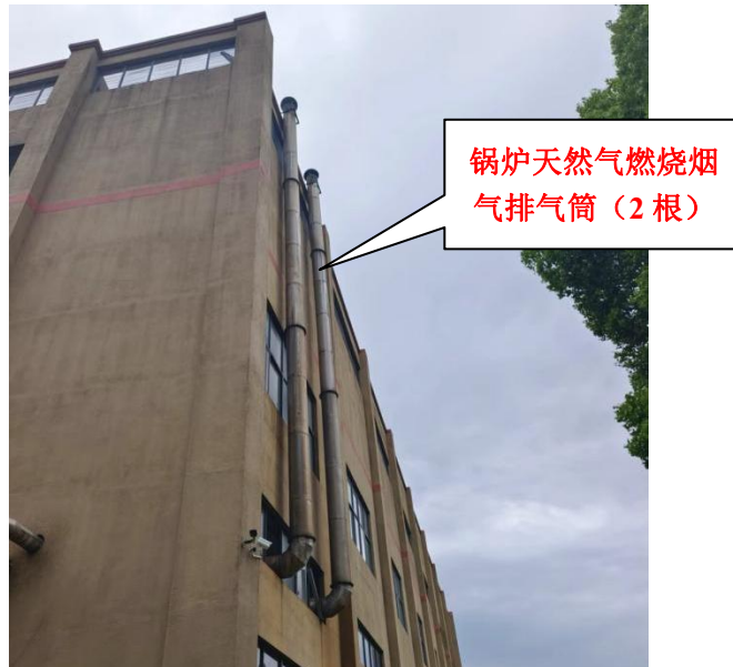
图 3-2 废气治理设施照片
