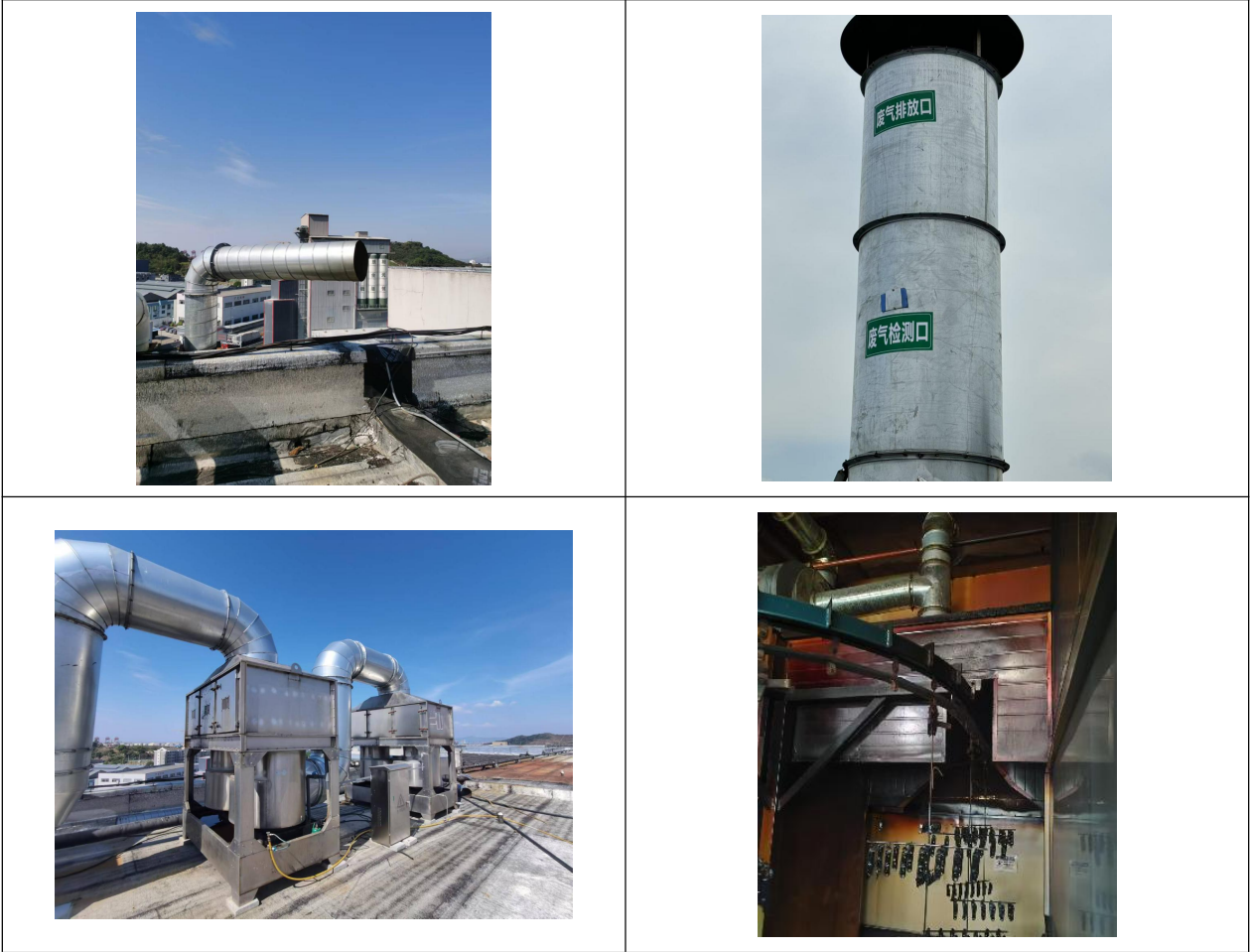
图 3-2 废气治理设施照片
