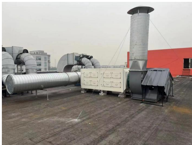
图 2 本项目废气处理工程（楼顶拍摄）
