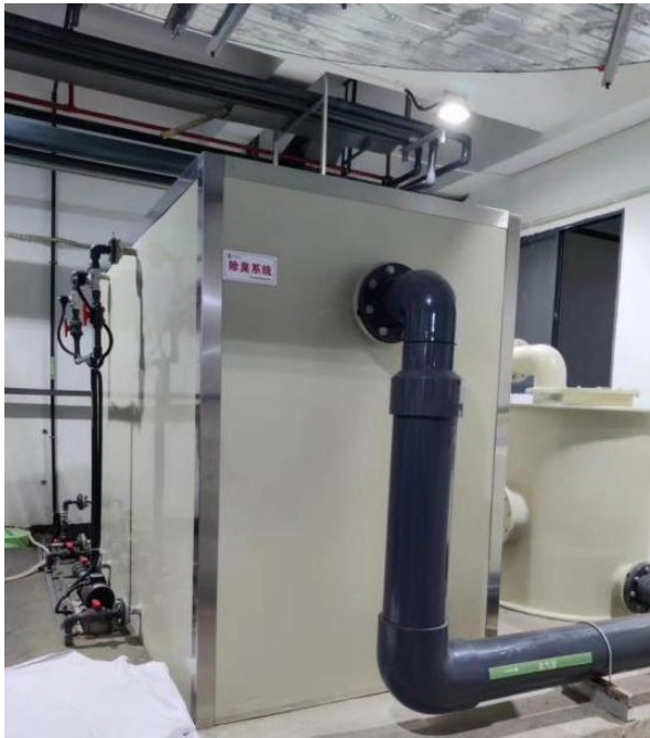
废水处理站除臭系统
