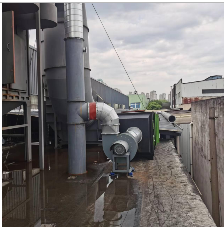
高压静电除油+活性炭吸附
