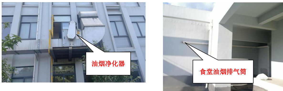
图 3-4 食堂油烟废气治理设施照片
