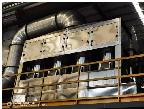
废气治理设施
