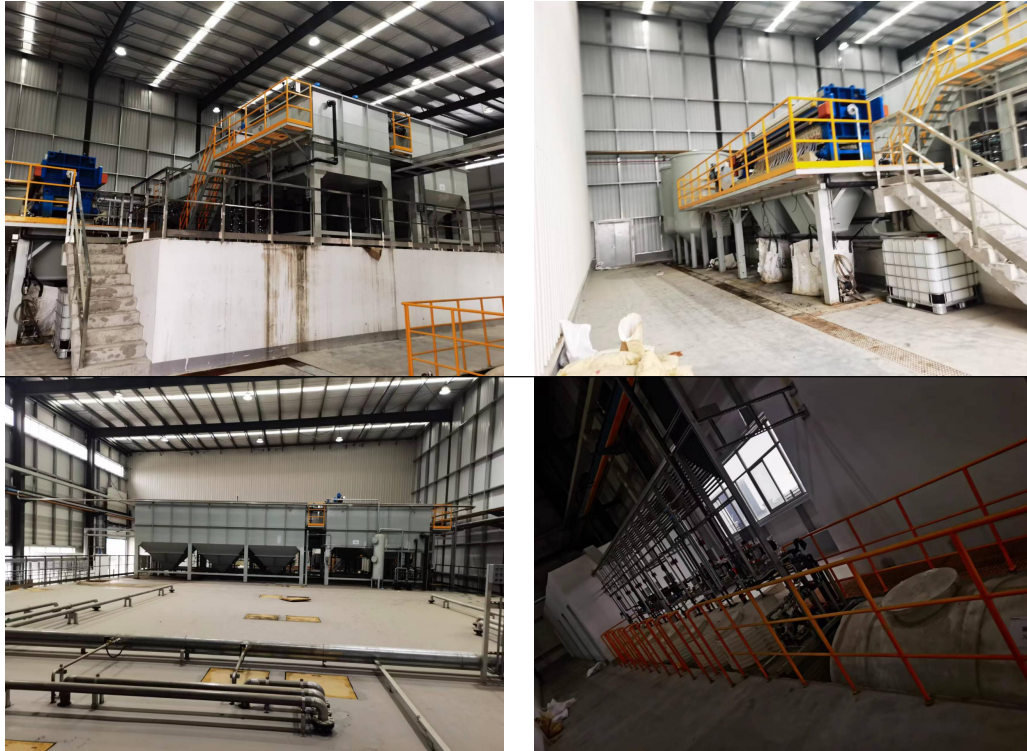
图 3-2 废水治理设施照片
