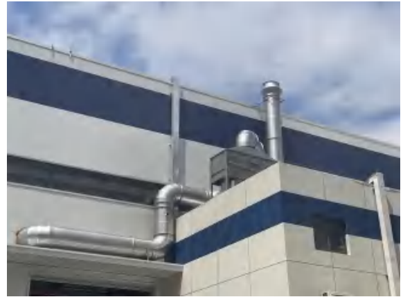
图 3-4 脱模废气治理设施照片
