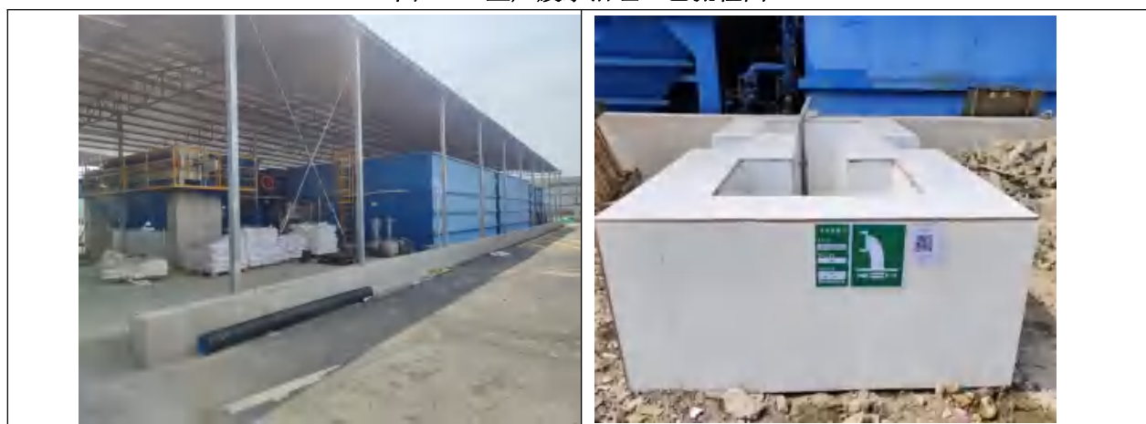
图 3-8 生产废水治理设施照片
