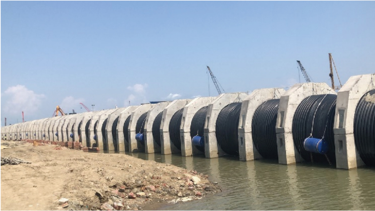
大型海洋取排水管道
