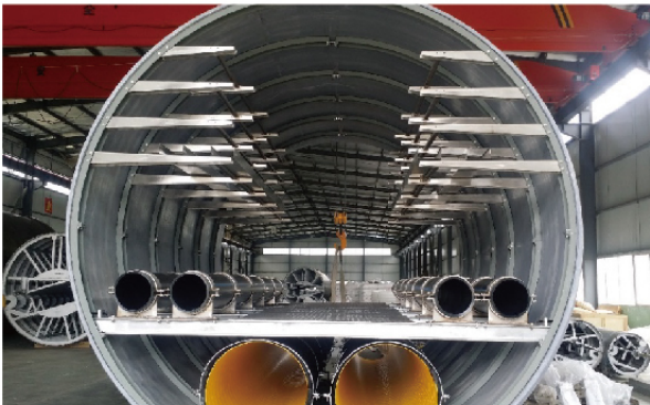
市政地下管廊
